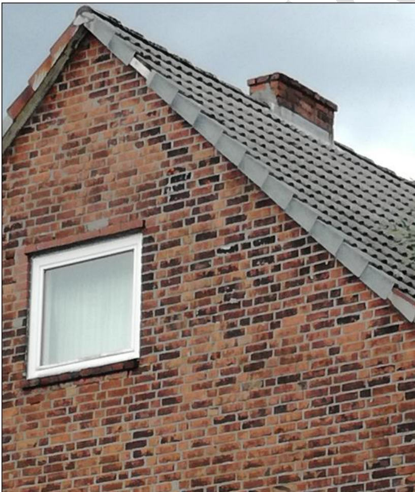
Giebelseite mit Defekt im Dachbereich, Möglichkeit für Fledermausquartiere
